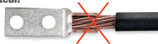
Dénudage trop long
