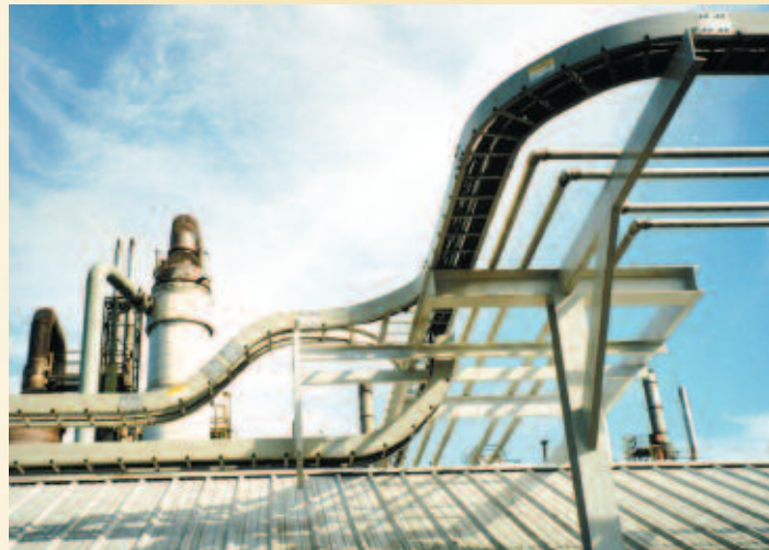
Descentes horizontale et verticale, installation extérieure.
