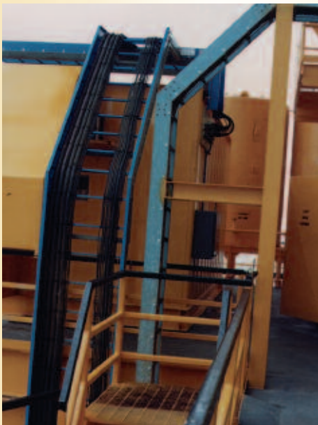
Descente verticale de câbles à partir d'un parcours horizontal.
