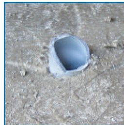
Broken conduit on jobsite
