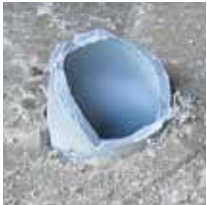
Broken conduit on jobsite
